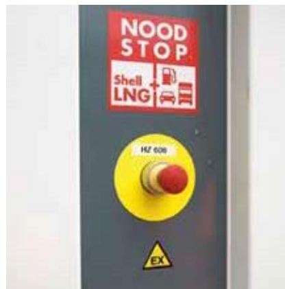
Tlačidlo núdzového vypnutia
